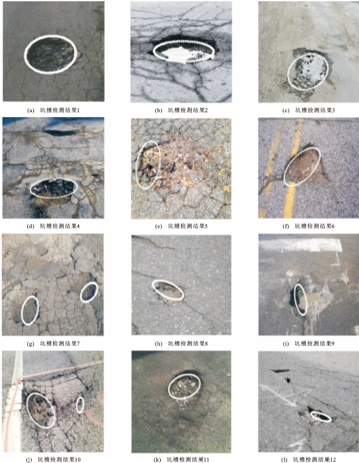
图 19 沥青路面中被检测出的坑槽
