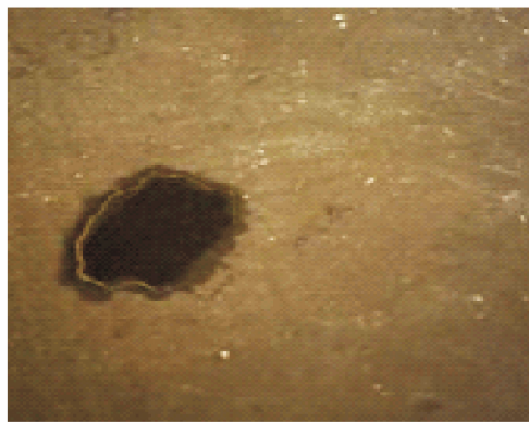
(b) 检测的坑槽
